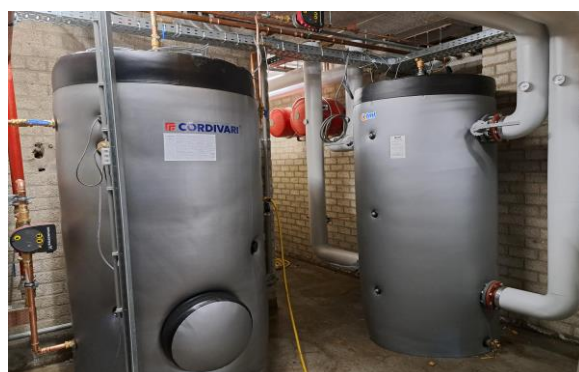
Buffervaten in de technische ruimte
