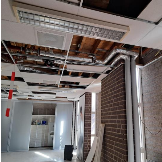
Stijgleidingen in de danszaal
