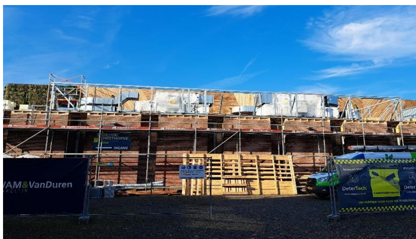
Luchtbehandelingskasten op het dak
